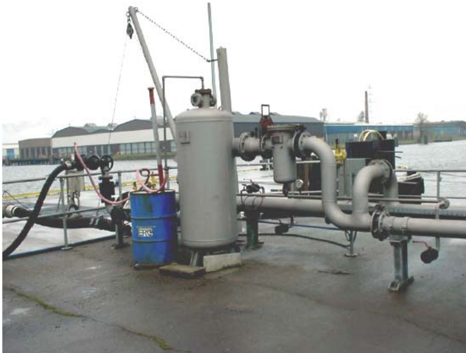
Anlage zur Befüllung von Tankschiffen auf einem Ponton
